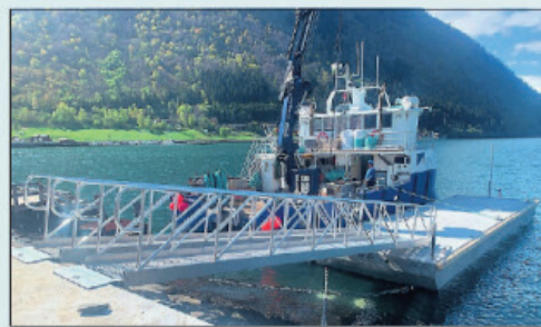
TRYGT I VÊR OG VIND: Det er levert sikringsstolpar på kvar side av landgangane for å hindra at dei fell i fjorden ved sterk vind og bølger. Installasjonen kan også takast på land etter sesongen er over. BEGGE FOTO: MARINA SOLUTIONS
